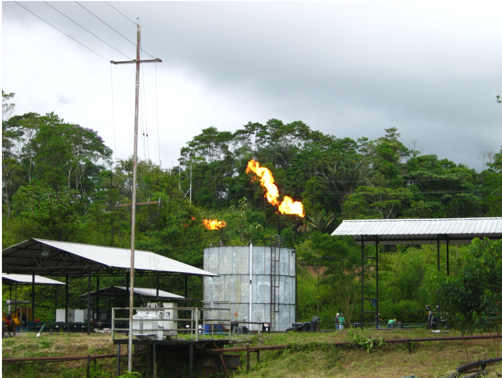
Torchères à la sortie d'un puits, via Auca
